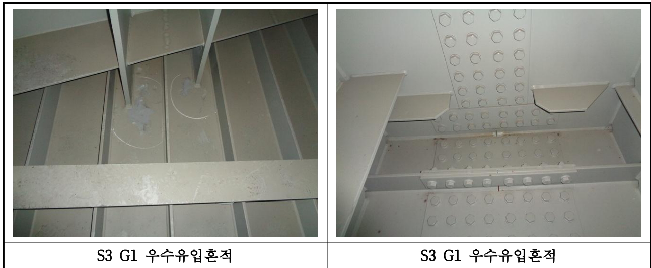
【사진 3.6】강박스 거더 내부 손상현황(계속)
