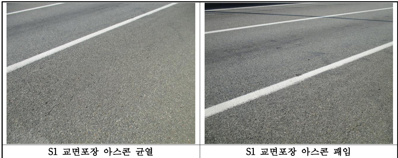
【사진 3.21】 교면포장 손상현황
