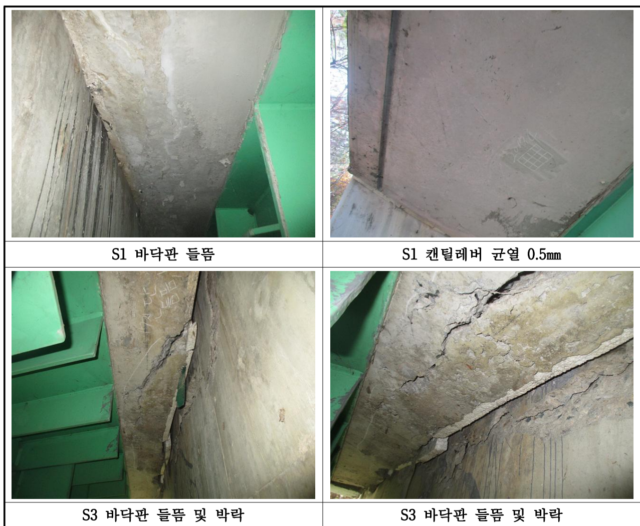
【사진 3.3】바닥판 손상현황
