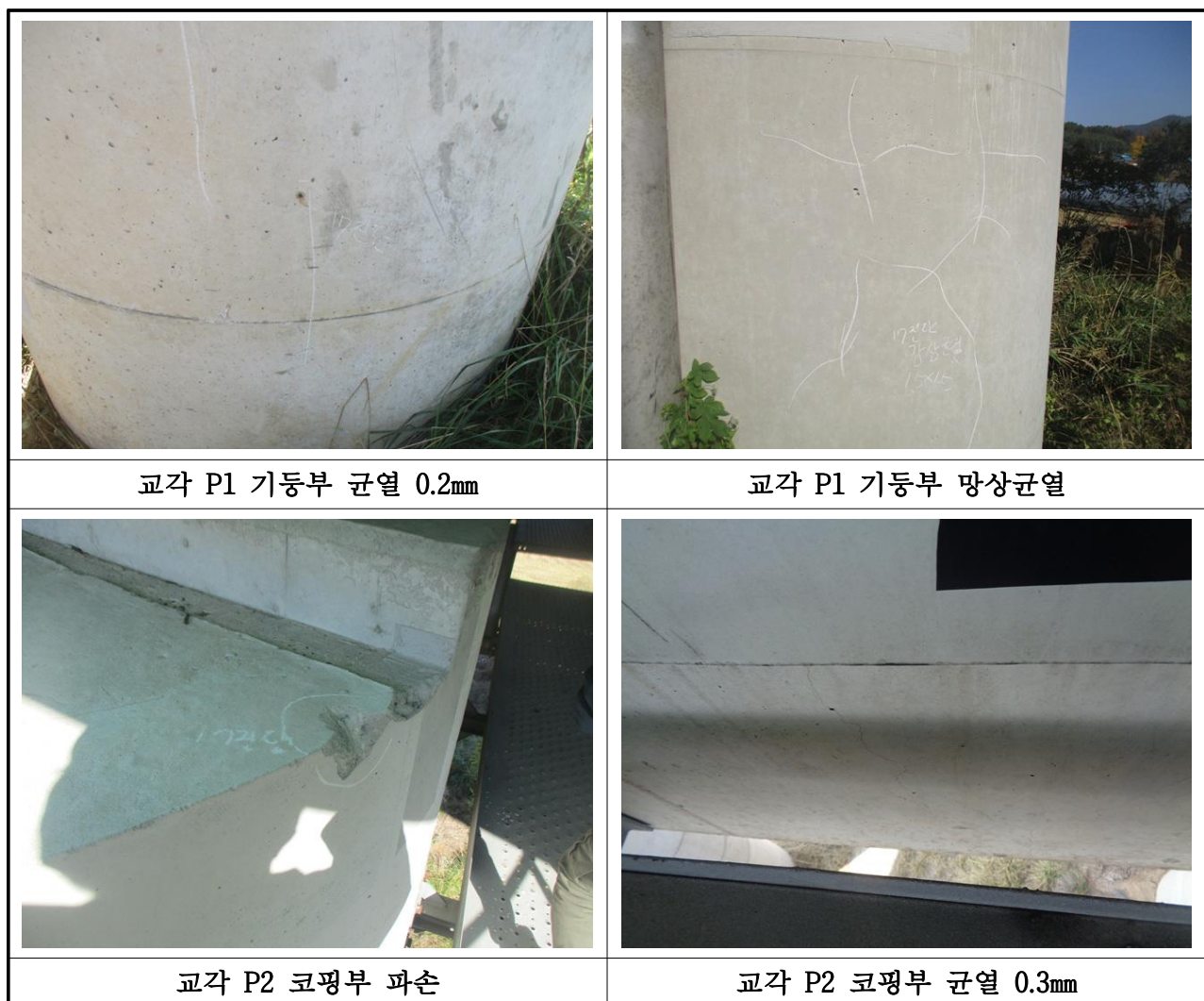
【사진 3.14】 교각 손상현황
