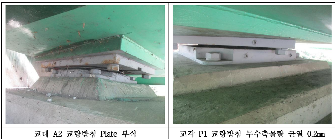
【사진 3.15】 교량받침 손상현황
