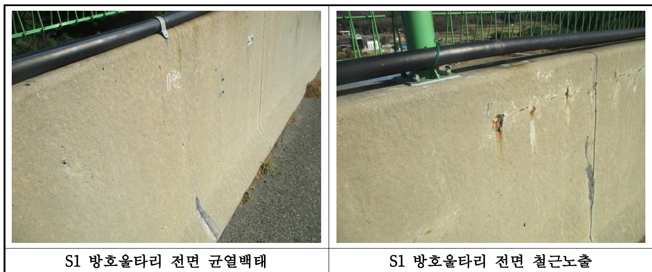
【사진 3.25】 난간 및 연석 손상현황
