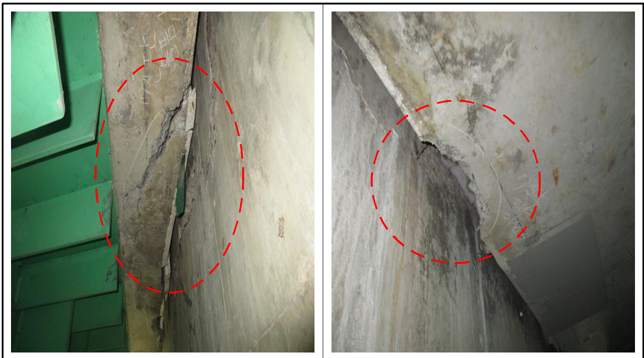
【사진 3.4】바닥판 들뜸 및 박락 현황
